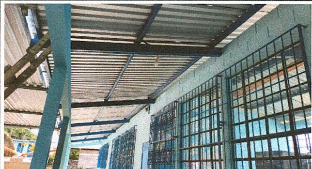
Foto 1: Así quedaron los balcones de las ventanas del Edificio Público
